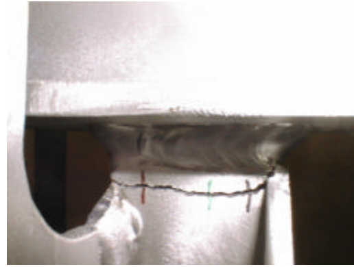
Figur 6.12 Revne i HAZ for den reparerede svejsning.
