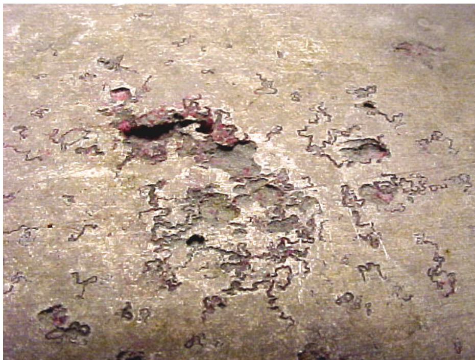
Figur 6.27. Korrosionsangreb på aluminiumplader af EN AW 5083 på broen imellem pontonerne som følge af sensibilisering af legeringen. Sensibiliseringen af de ubeskyttede overflader på indersiden af hulrummets bund kombineret med adgang af havvand, som ikke effektivt er bortledt.
