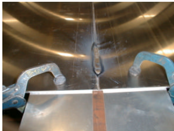
Figur 2.145 Ca. 60 mm hæftning med 150 mm mellemrum. Ved girdere længere hæftninger, 70-80 mm. MIG svejst.
