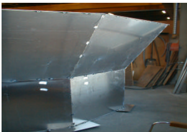
Figur 2.165 Opstillede og hæftede delpaneler, model C1, Bemærk hjælpe vinkelbeslagene nederst på panelerne.
