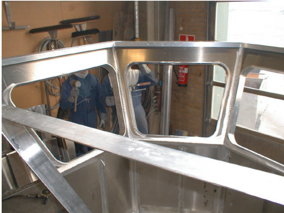
Figur 2.173 Styrehus C2 med fuldsvejste vinduesrammer.
